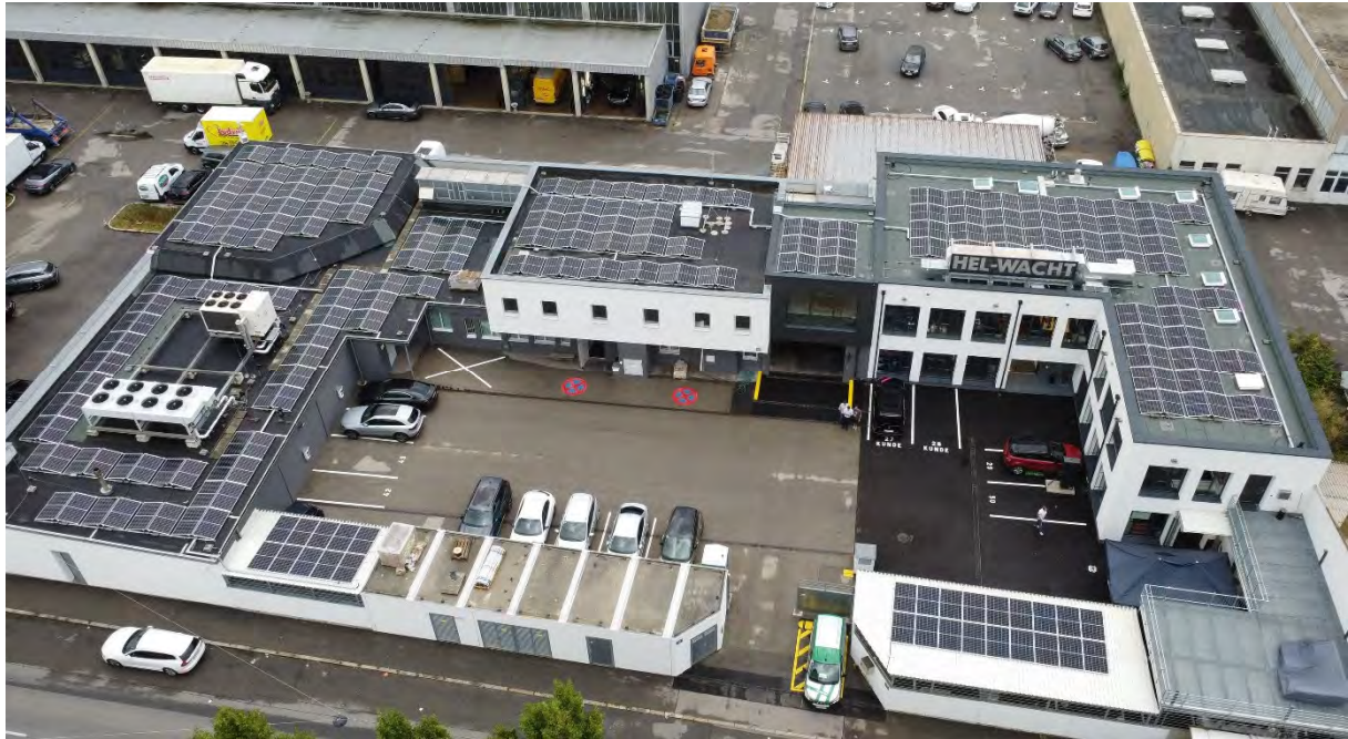
Abbildung 11: Photovoltaikanlage am Standort Scheydgasse
